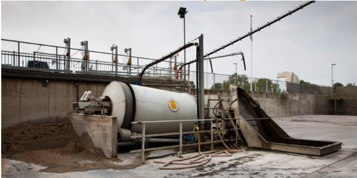
Een recyclinginstallatie wordt gebruikt voor het terugwinnen van de grondstoffen uit het spoelwater en restbeton.
